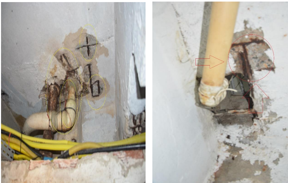
Figura 8 - Instalações hidrossanitárias irregulares e exposição de armaduras
