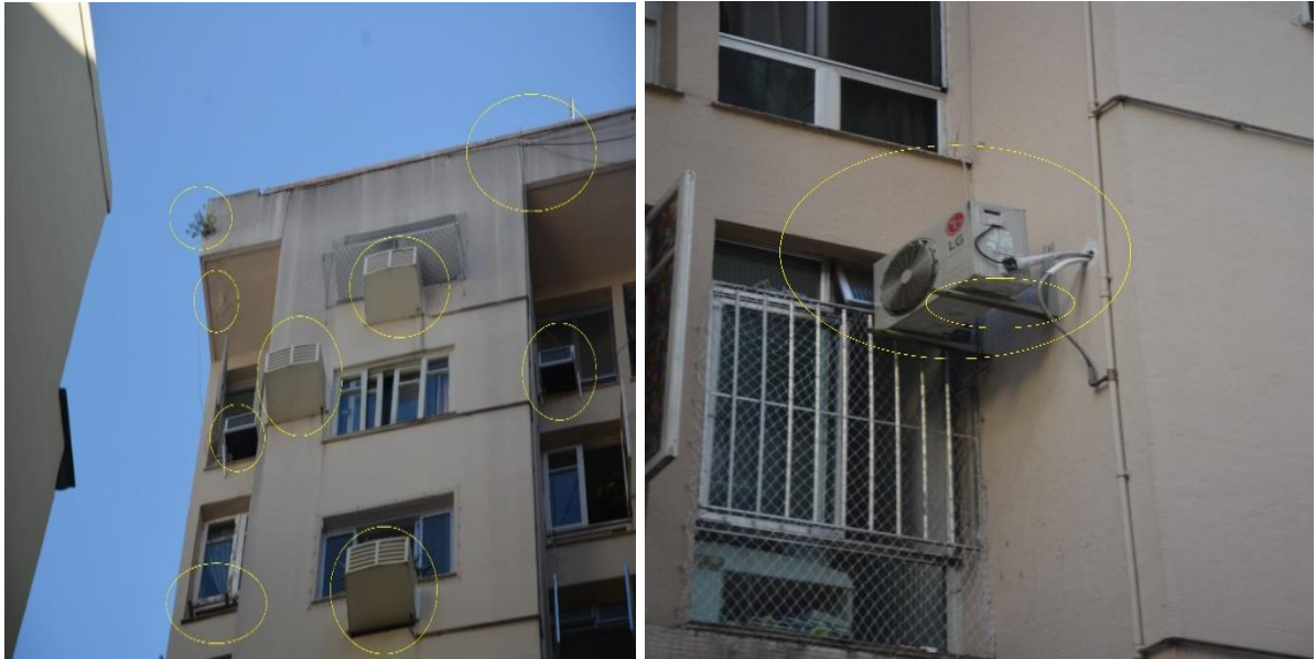
Figura 3 - Alterações em fachadas
