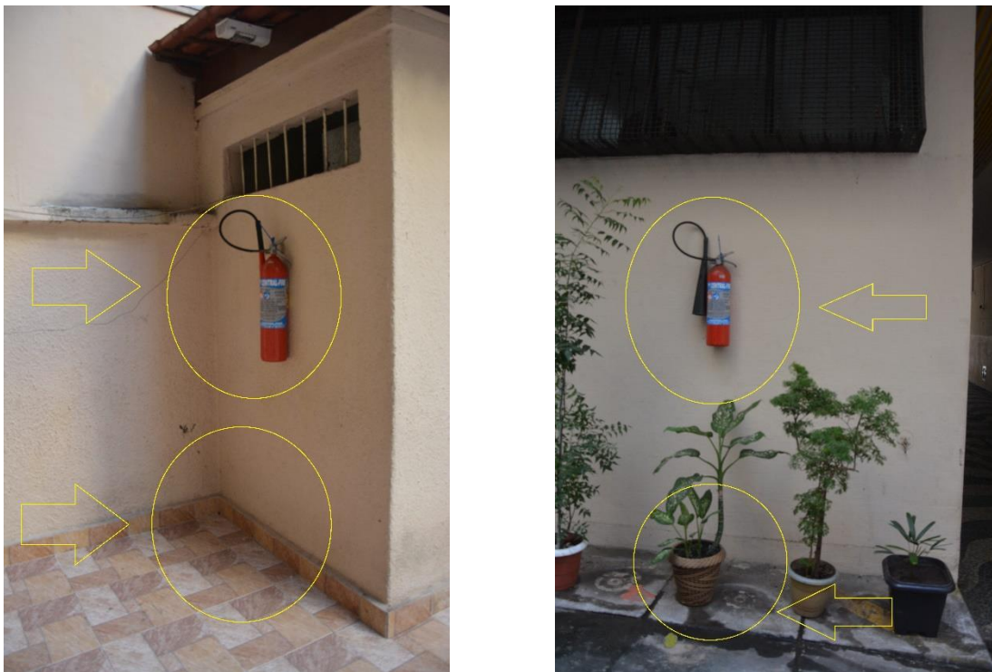
Figura 4 - Extintores com irregularidades
