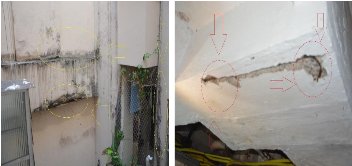
Figura 5 – Exposição de armaduras
