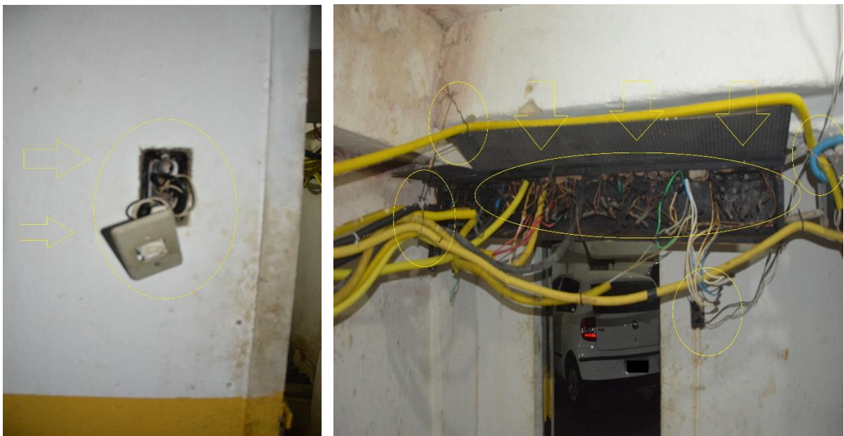
Figura 6 - Instalações elétricas com irregularidades
