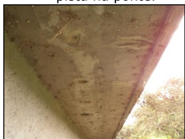
(d) Falha no funcionamento dos drenos e da pingadeira.
