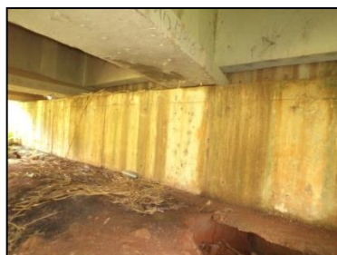
(g) Excesso de umidade e manchas no encontro.
