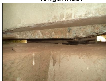
(h) Deformação do aparelho de apoio de neoprene.
