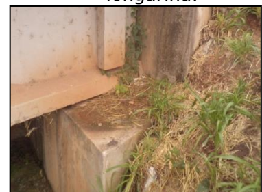
(i) Detritos no apoio de uma longarina no encontro.
