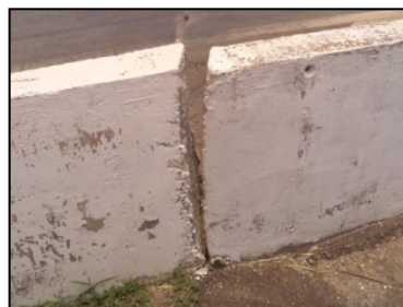
(b) Desalinhamento vertical da barreira New Jersey.
