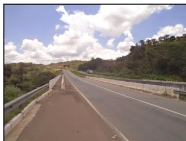
(a) Estreitamento de pista na ponte.
