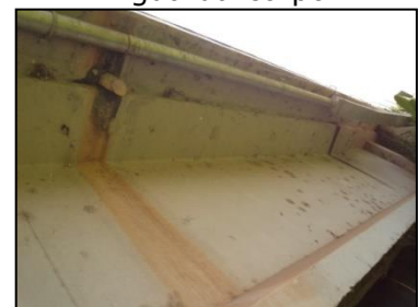
(f) Mancha de infiltração na laje e na longarina.
