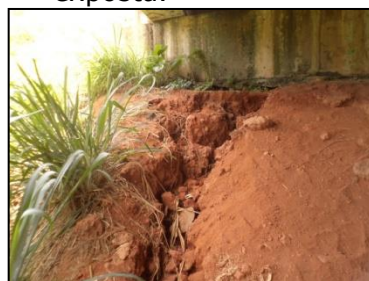
(h) Ausência de proteção vegetal e erosão no talude.
