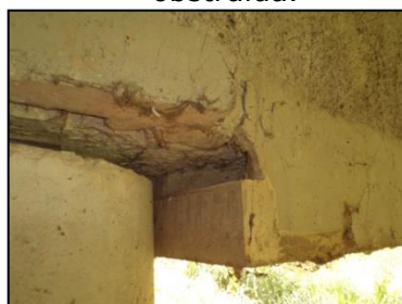
(e) Falha de concretagem, com armadura exposta nas longarinas.
