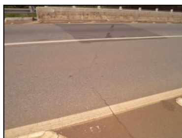
(b) Junta de dilatação obstruída.
