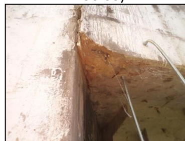
(e) Desplacamento na laje, com corrosão exposta.
