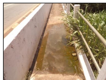
(c) Acúmulo de água no piso da passarela.
