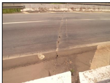
(d) Junta de dilatação obstruída.
