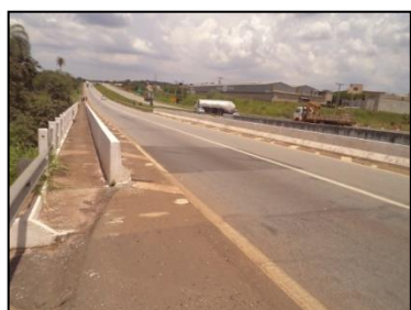
(a) Estreitamento de pista na ponte.
