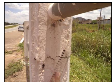
(c) Fissura com abertura de 2,0 mm no guarda-corpo.
