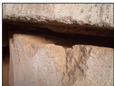
(g) Trinca e deslocamento do concreto no topo do pilar.
